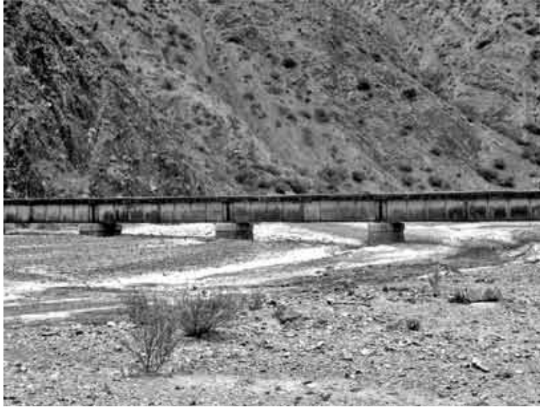
Fig. 7: Puente de la vía férrea cruzando un tributario del Río Tupiza inmediatamente aguas abajo del Río Tatasi. Residentes locales mencionaron que en los pasados años, camiones grandes podían pasar debajo del puente. Actualmente, la máxima altura debajo del puente es de aproximadamente 1.50 m.
